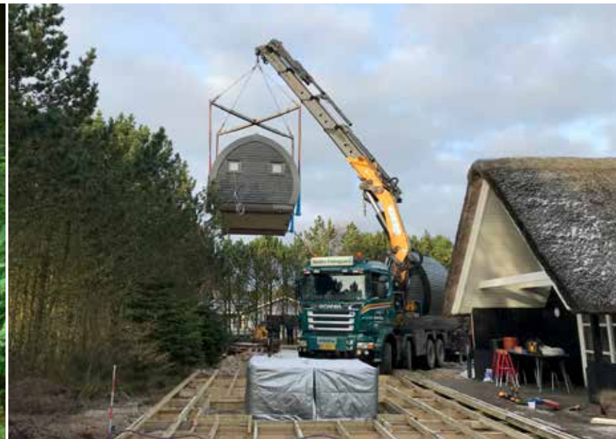
Færdigsamlet Natursuite leveres på lastbil og er klar til indflytning efter tilslutning.
